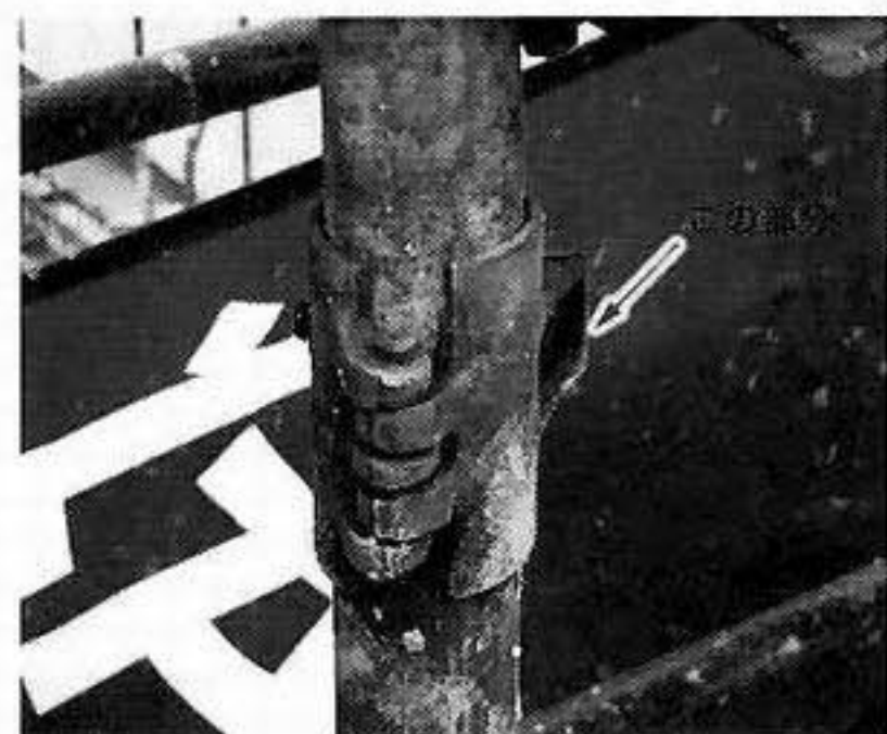
単管パイプのクランプ(錆びてます)
